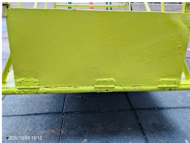
Figura 88: Solda no guarda-corpo
